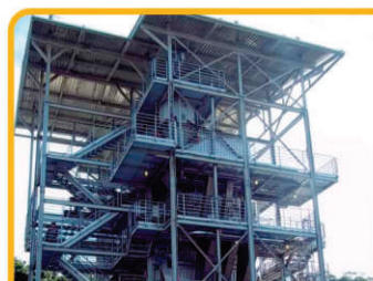
CARGILL AGRÍCOLA LTDA - Ilhéus - BA Caldeira EVM-900; 25 ton/h; 15 kgf/cm²; 200 °C
