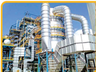
WD AGROINDUSTRIAL - João Pinheiro - MG Caldeira EV-2-4200; 170 ton/h; 67 kgf/cm²; 520 °C
