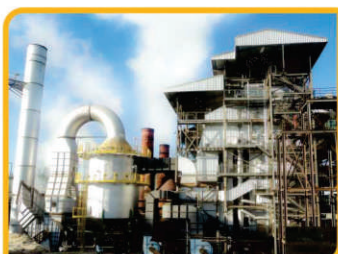
COPRODIA - Campo Novo do Parecis - MT Caldeira EV-2-3000; 120 ton/h; 52 kgf/cm²; 420 °C
