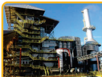
CARGILL AGRÍCOLA S/A - Uberlândia - MG Caldeira EV-2-4500; 180 ton/h; 67 kgf/cm²; 510 °C
