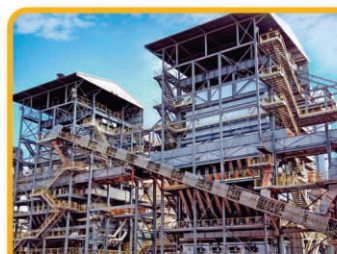
USINA SANTA ISABEL - Mendonça - SP Caldeira nº 01 EV-2-5000; 200 ton/h; 64 kgf/cm²; 480 °C Caldeira nº 02 EV-2-5750; 230 ton/h; 66 kgf/cm²; 490 °C
