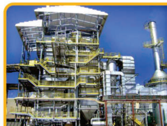
CARGILL AGRÍCOLA S/A - Primavera do Leste - MT Caldeira EV-2-1300; 50 ton/h; 64 kgf/cm²; 480 °C
