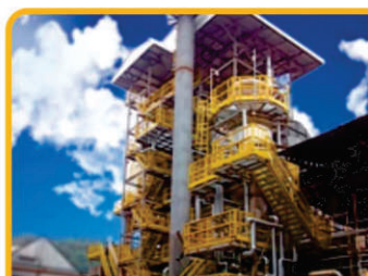
ADM DO BRASIL LTDA - Joaçaba - SC Caldeira EV-2-900; 35 ton/h; 15 kgf/cm²; 200 °C
