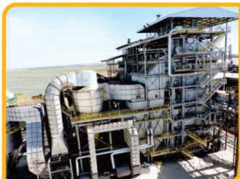
USINA CERRADÃO - Frutal - MG Caldeira EV-2-5000; 200 ton/h; 65 kgf/cm²; 490 °C
